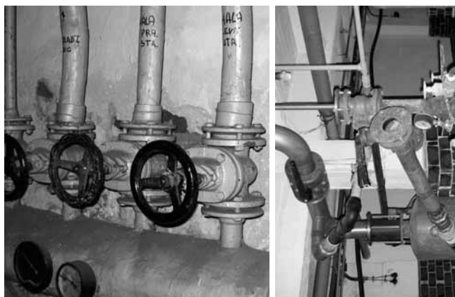
Pavilon Glauberových pramenů – v podzemí „soňná“ technologie rozvodu vod
